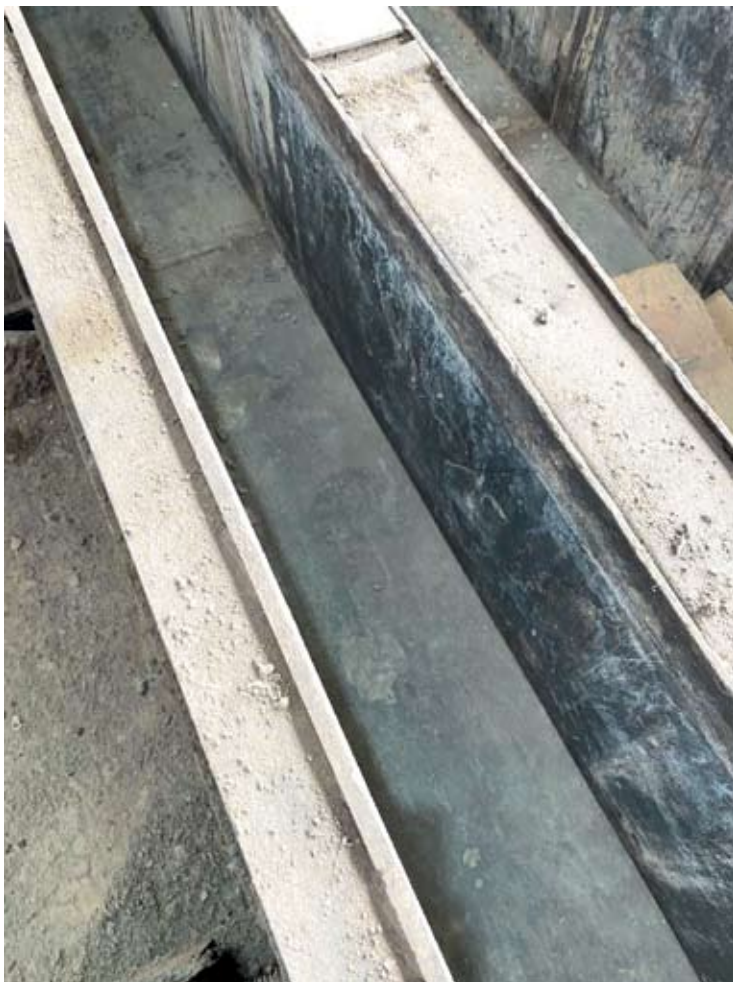
Рис. 1. Образование цементного молочка на стенках опалубки
