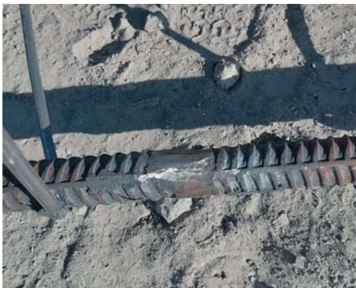
Рис. 4. Пример уменьшения диаметра арматуры при зачистке сварного шва
